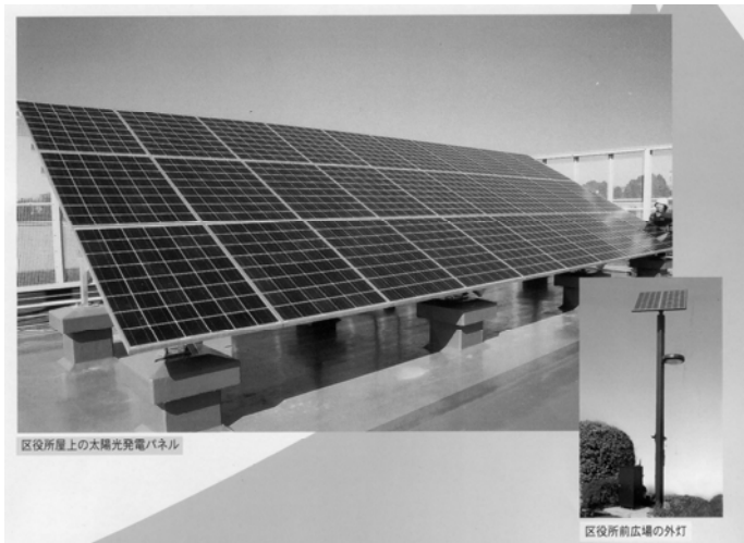
図8 麻生区役所屋上の太陽光発電パネルと駐車場のソーラー外灯
